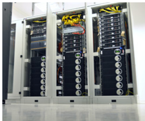
Rys. 2. Serwerownia w Centrum Zarządzającym w Warszawie.
